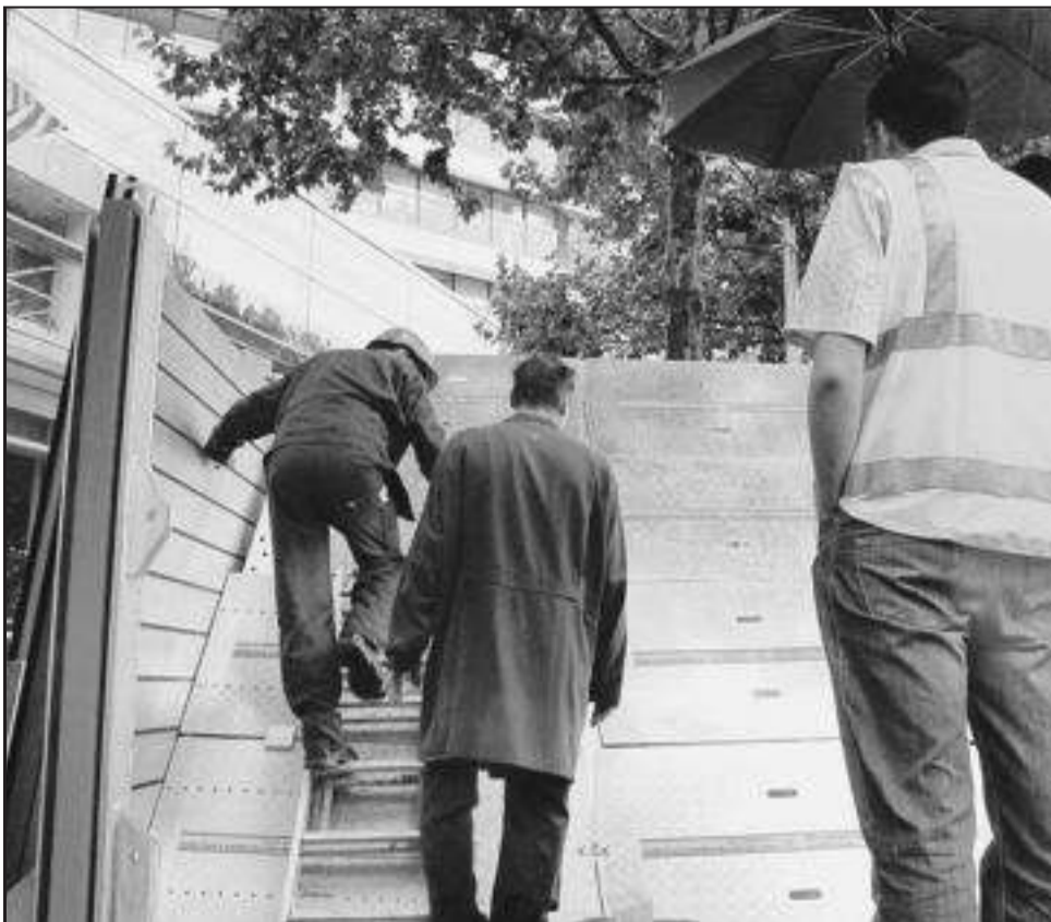
Depuis 2001, Paris se prépare à se retrouver les pieds dans l'eau. Si cela devait se produire, 800 m de barrières anticrue constituées de planches d'aluminium seraient notamment élevées sur la chaussée. (LP/BENOIT HASSE.)
